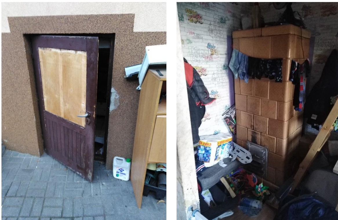
Fotografia 1. Po lewej: prowizoryczne obicie ubytków w drzwiach do kotłowni sklejką. Po prawej: czynny piec kaflowy na węgiel przy łóżku piętrowym dzieci.
